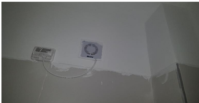
מדרש להסיר שיירי חומרי בנין בצורה מקצועית. זאת בניגוד לתיי 5044 חלק 2 סעיף 3.2.4.
